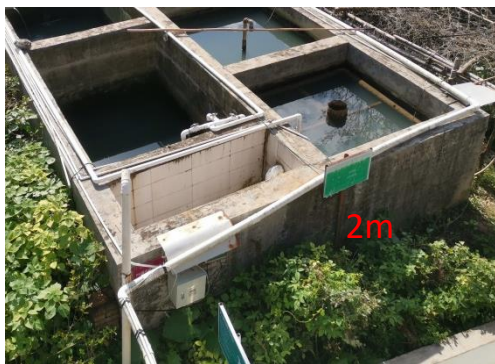
矿坑涌水水处理池
