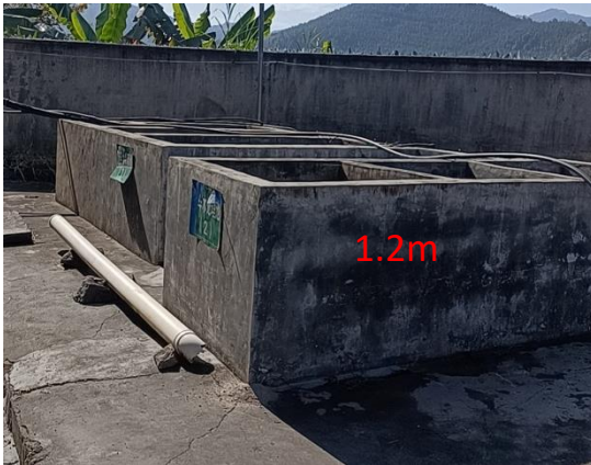
洗车水处理池
